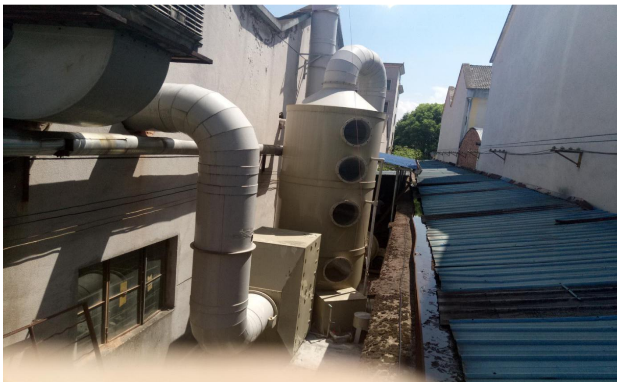
图 5：废气处理设备
